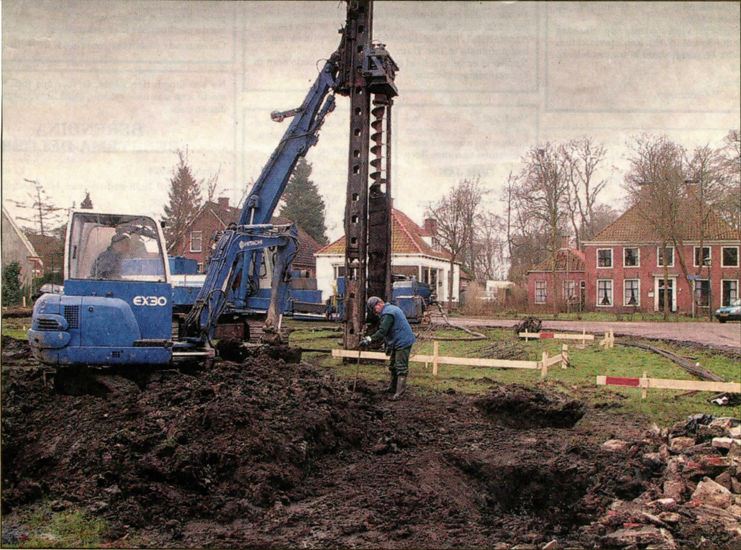
▲ Op de hoek van de Voorstraat en Molenlaan in Oudeschans is begonnen met het leggen van de fundering voor het nieuwe Vestingmuseum. Er worden gaten in de grond geboord die worden volgestort met beton.
